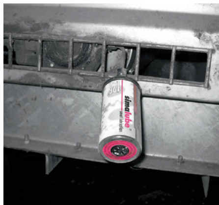
simalube lubrica el rodamiento de una cinta transportadora.
