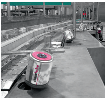
Pista de relleno equipada con varios lubricadores simalube.
