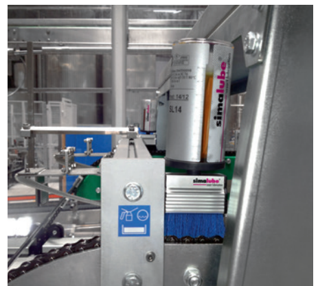
Die beiden simalube mit Bürste schmieren die Kette in einer Brauerei.
