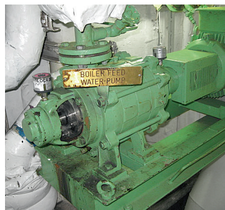
Les graisseurs simalube de 30 ml sont installés sur la pompe à eau de la chaudière à vapeur.
