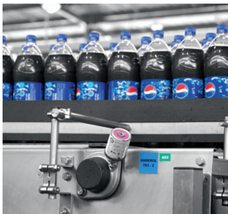
Lubrification d'un palier à bride pour une ligne de remplissage de boissons non alcoolisées.
