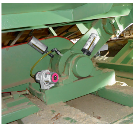
Les paliers d'une goulotte vibrante sont alimentés de façon continue par trois graisseurs.
