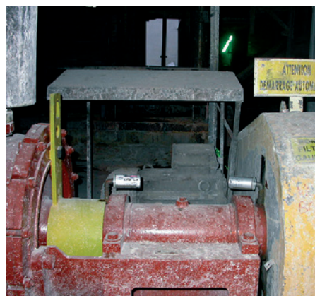
Lubricación de los rodamientos del eje de accionamiento principal de una bomba de filtro.
