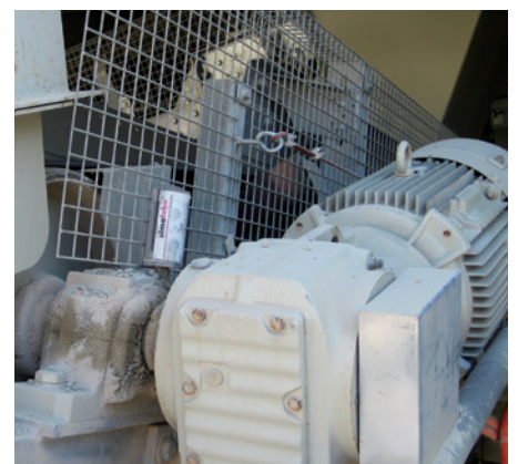
Lubricación de un rodamiento de soporte de una cinta transportadora.
