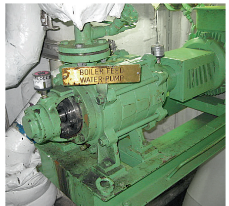
simalube 30ml sind auf der Wasserpumpe des Dampfkessels installiert.
