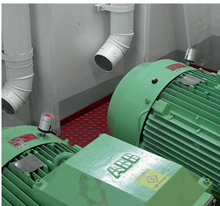
Die Elektromotoren von ABB sind mit 60 ml simalube Schmierstoffspendern ausgerüstet.
