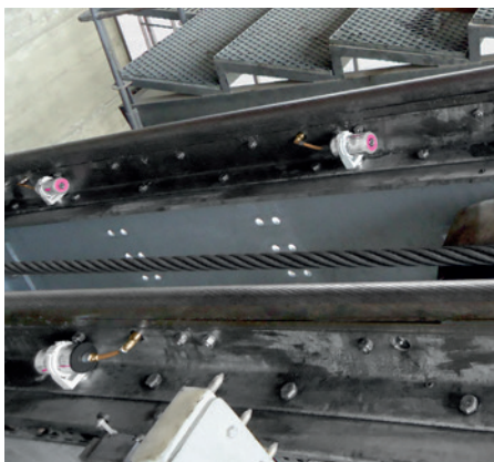
Mehrere Schmierstoffspender sind auf einem Seilsattel montiert. Dank der Montage einer Magnethalteschelle werden aufwändige Installationen umgangen.
