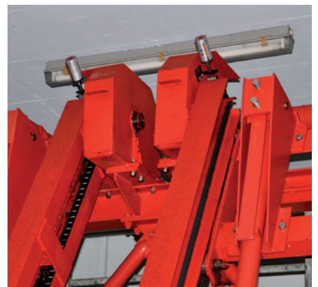
Lubrification de chaînes avec simalube, sur une grosse grille équipée de brosses.
