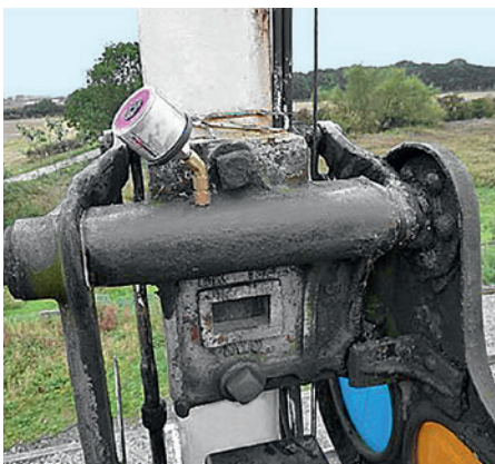
Das Gleitlager eines Eisenbahnsignals wird von einem 30 ml simalube Schmierstoffspender automatisch und kontinuierlich geschmiert.
