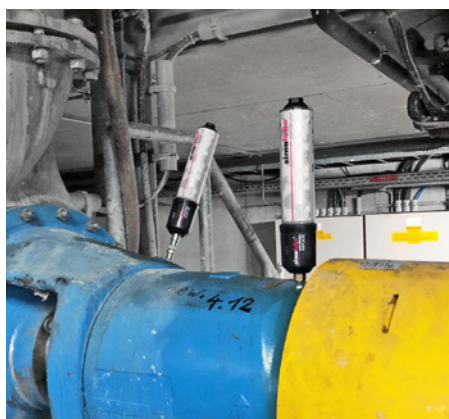
Les paliers de la pompe sont lubrifiés avec deux IMPULSE et simalube 250 ml.
