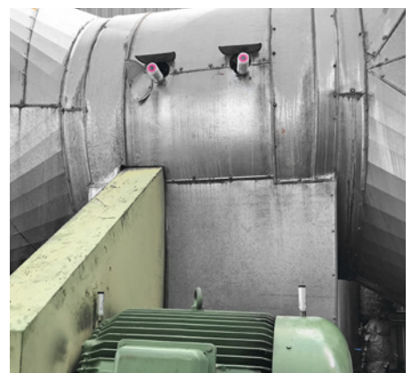
Lubrification des paliers d'un système de ventilation avec simalube 125 ml et 15 ml.
